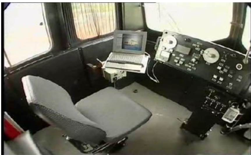
Рис. 4.29. Комп'ютер, встановлений на машині типу ВПР
